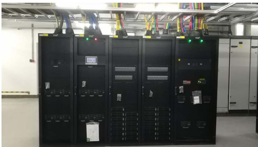
图 10 节能型智慧数据中心基础设施解决方案
